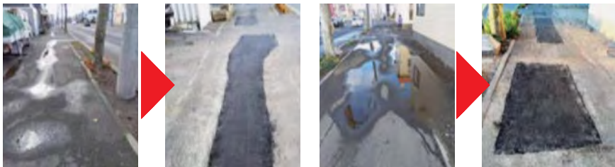
バス停付近の歩道が波打ち窪みができ、水たまりになっているところを補修・改善
